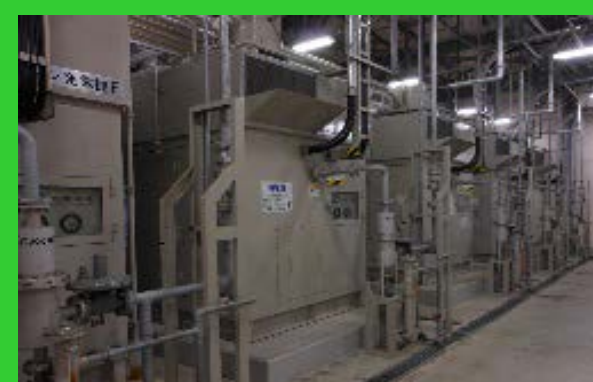
▲食品残渣生ゴミから抽出したバイオガスを利用した発電
